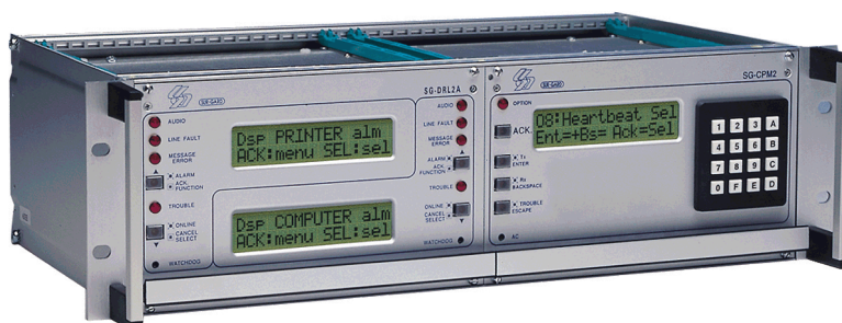
Телефонная базовая станция
